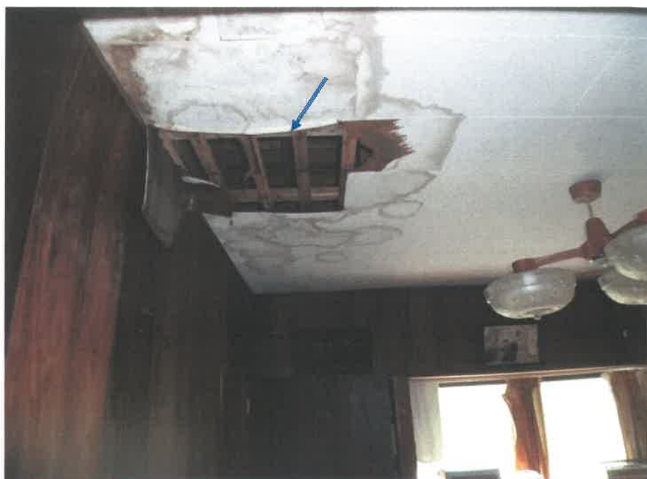
雨漏り跡の様子
