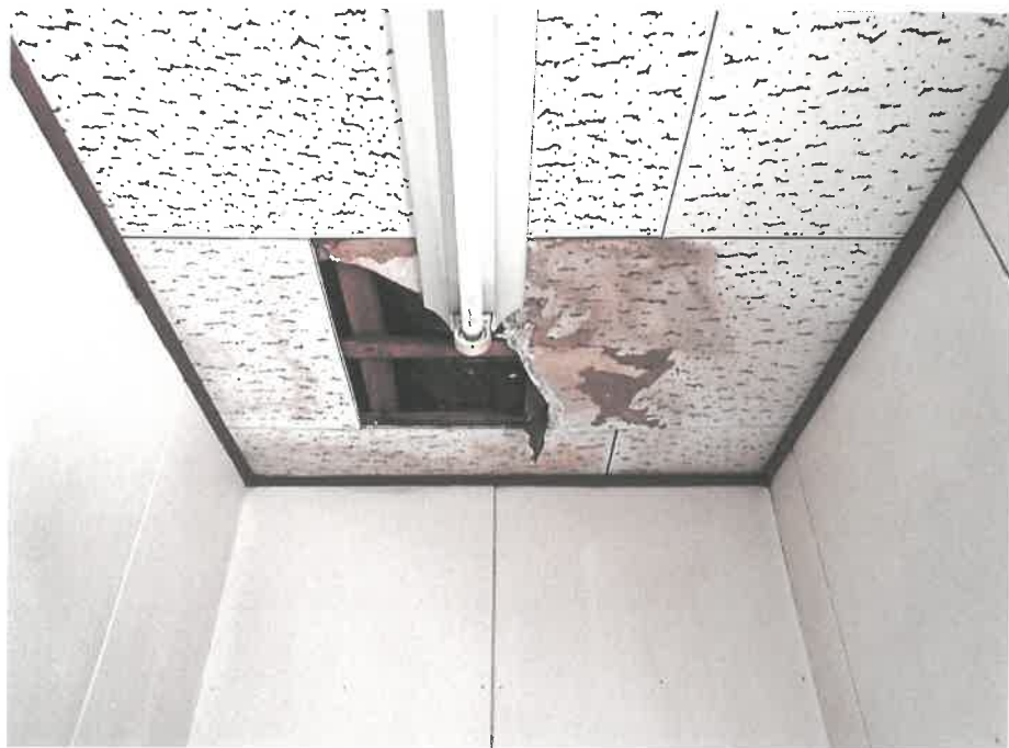
天井の破損箇所、雨漏り跡
