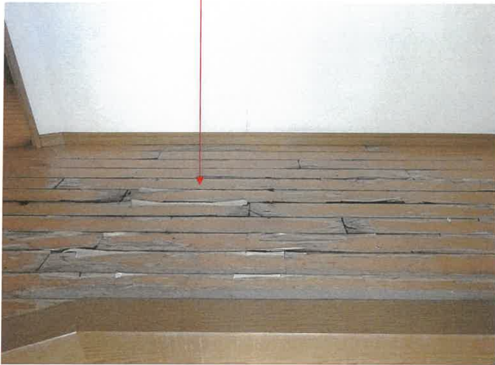
フローリングの傷み
