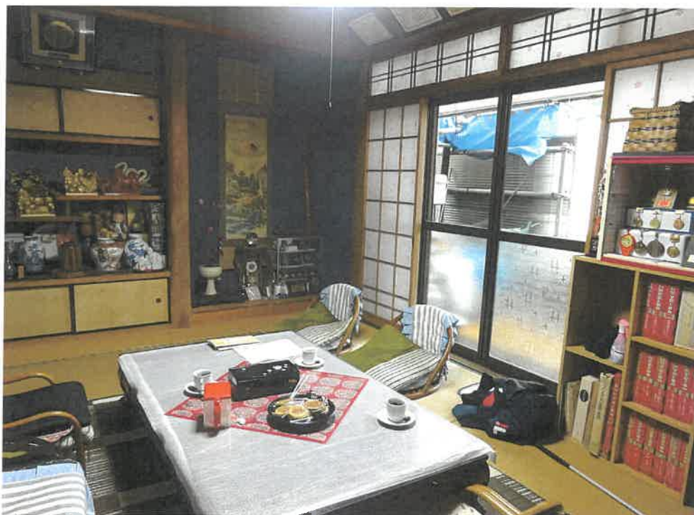
写真6 床の沈み込みを感じた箇所
