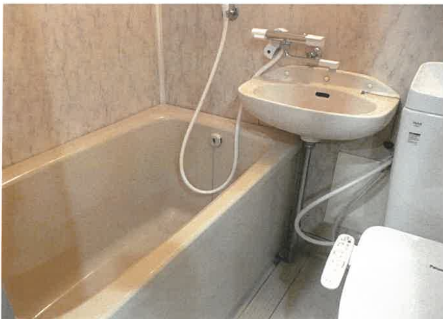
⑮ 3階テナント ユニットバス
