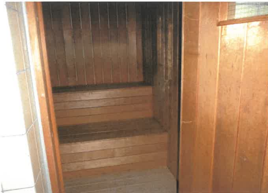
⑩ 2階テナント サウナ室
