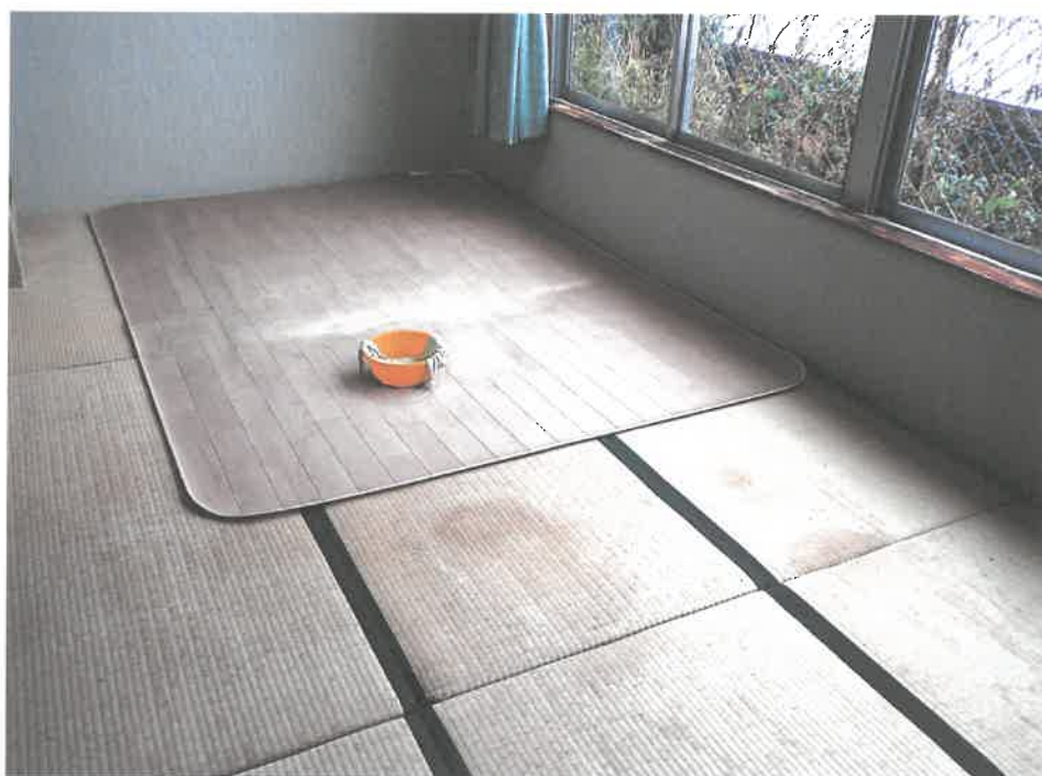
物件4 雨漏りの状況
