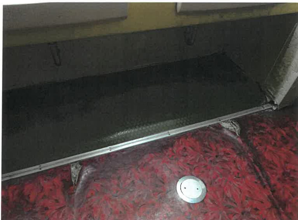
写真14 クロスの傷み
