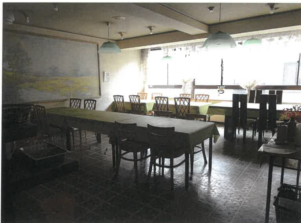
写真24 2階食堂内の壁クロスの傷み
