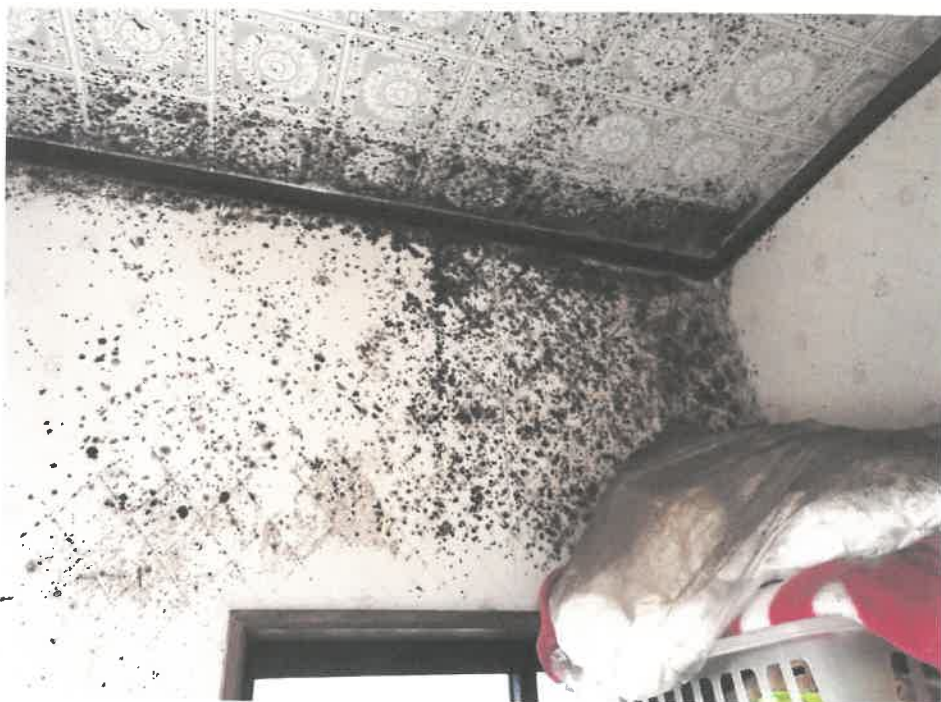
物件6 カビの発生状況
