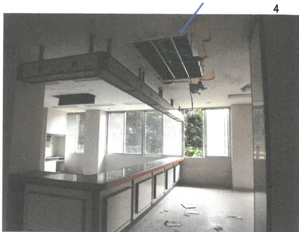
天井破損の様子
