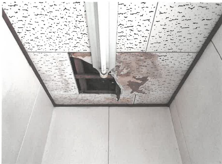
天井の破損箇所、雨漏り跡
