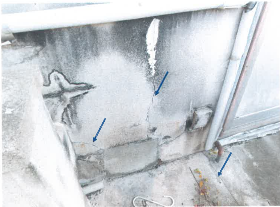
物件7 基礎・犬走りの亀裂の様子
