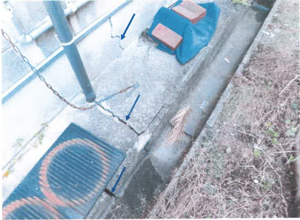
物件3 基礎・犬走りの亀裂の様子
