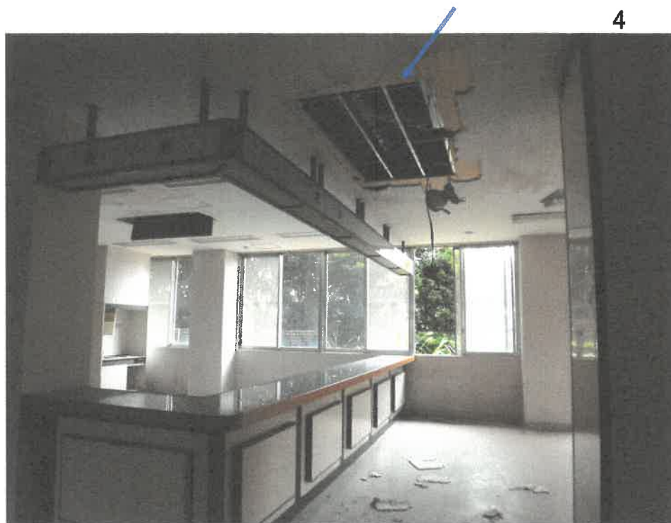
天井破損の様子
