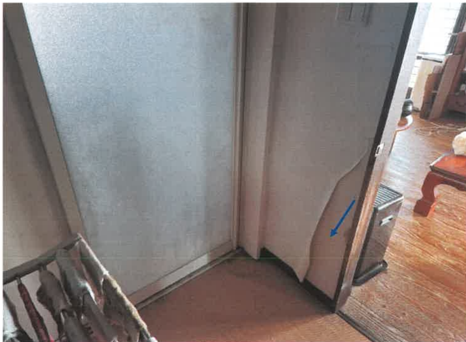
クロスの剥がれの様子
