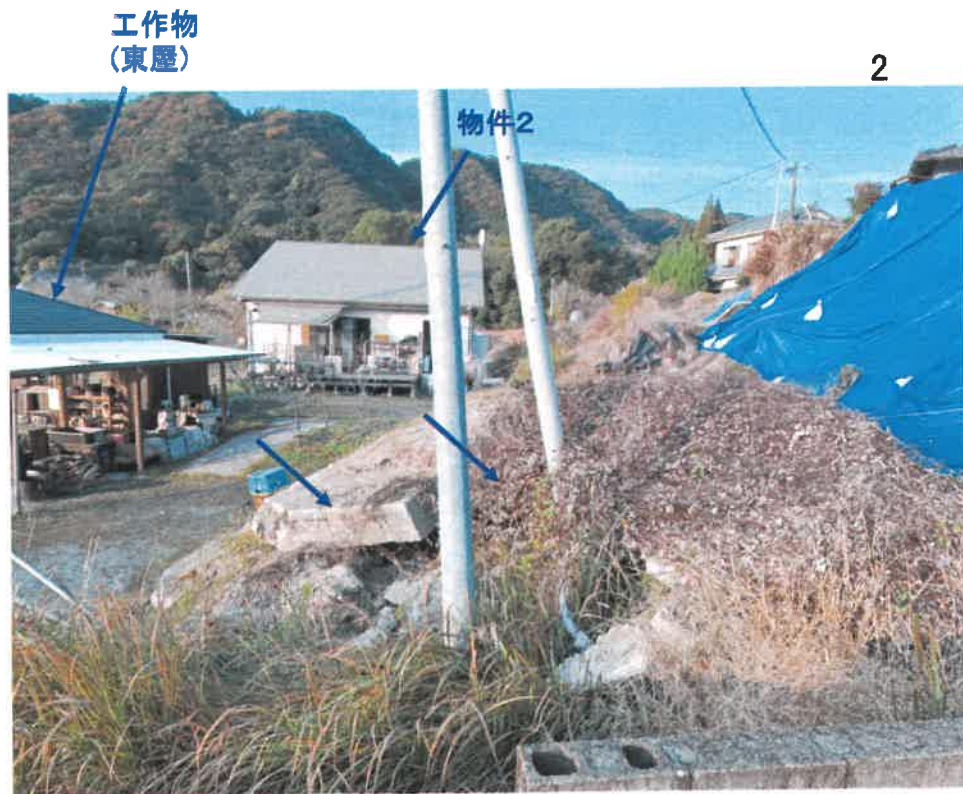
隣接地の法面の崩れ(土砂・擁壁の流出)の様子
