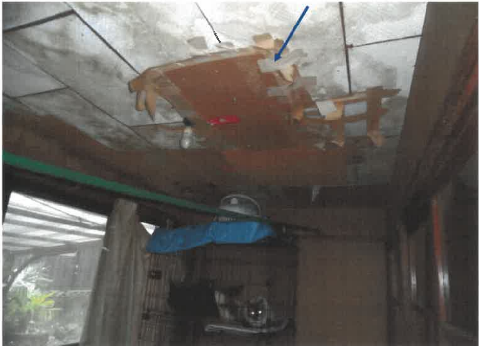
雨漏り跡の様子
