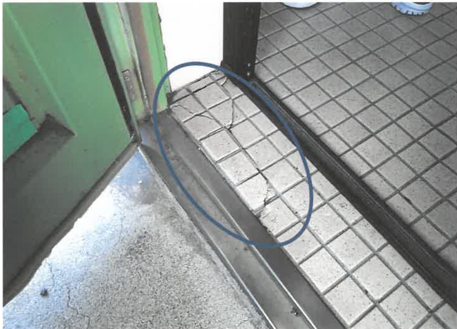
玄関タイルの亀裂箇所
