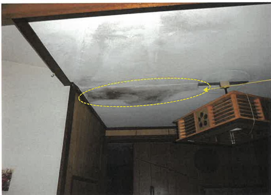
⑥ 1階トイレ前天井
