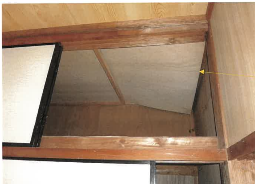
⑨物件 2 押入れ天井
