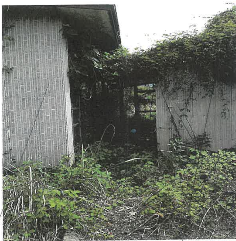
物件 2 屋根破損箇所 写真 10
