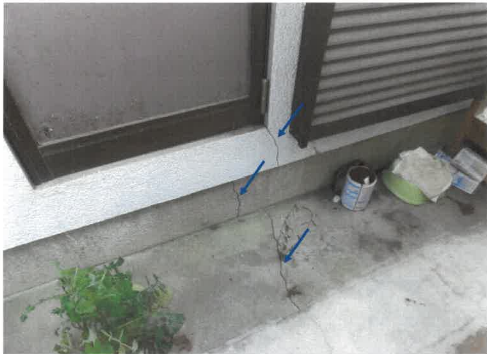
外壁・基礎・犬走りの亀裂の様子
