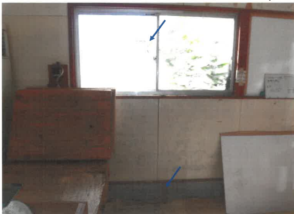
ガラスの破損・基礎の亀裂の様子
