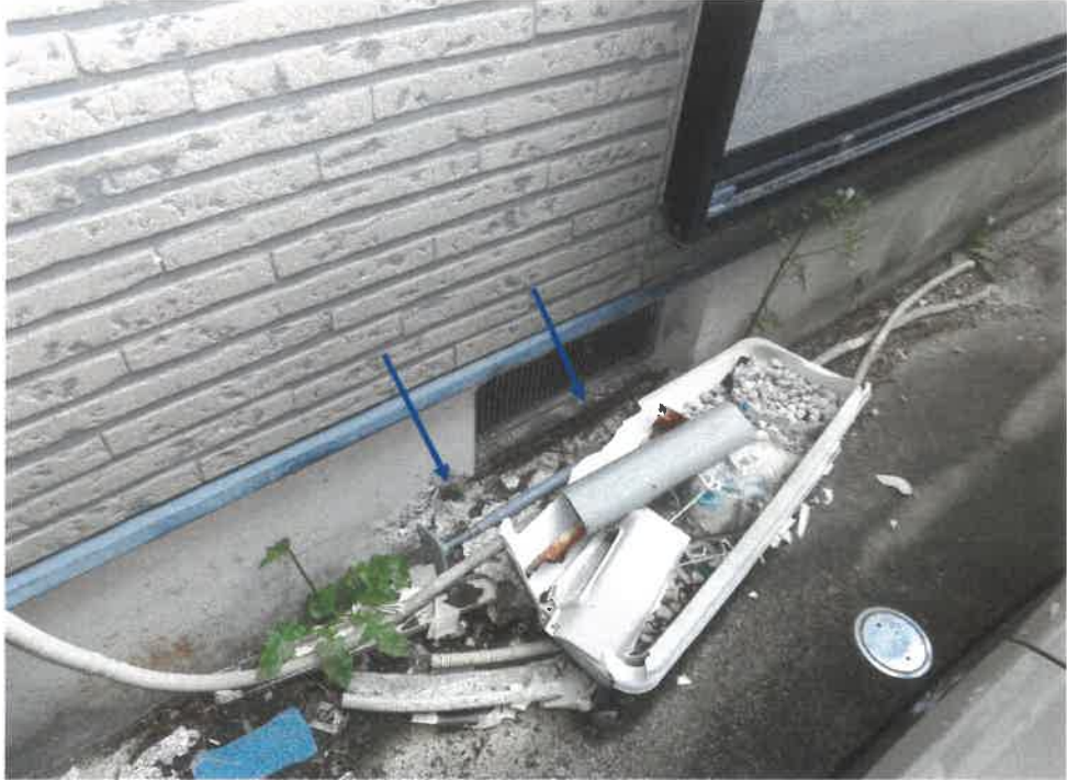
基礎の剥がれの様子
