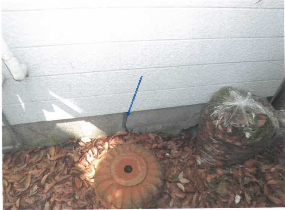
基礎の亀裂の様子
