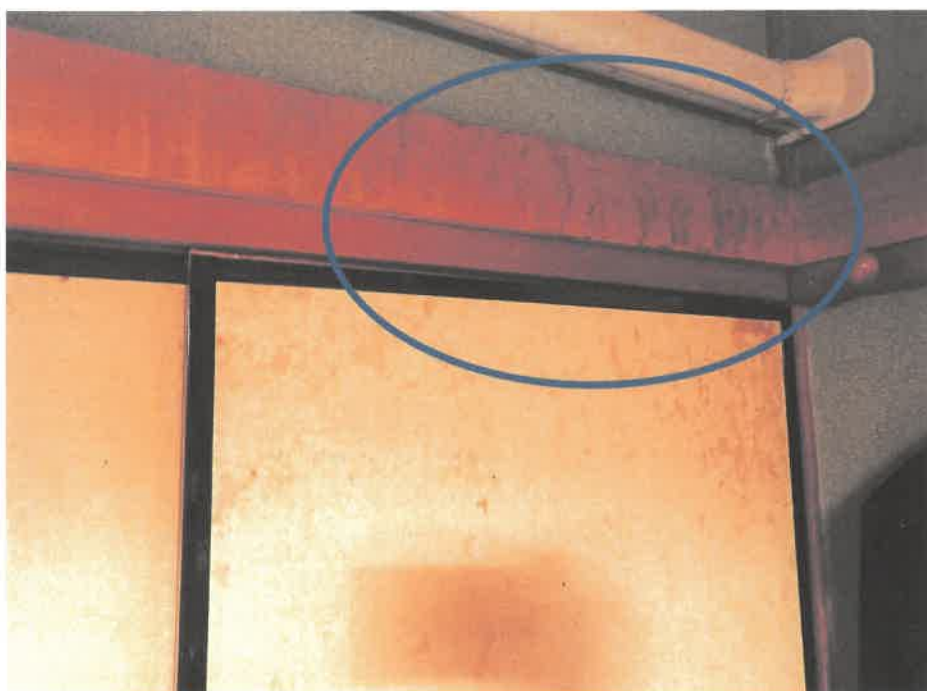
1階 和室 雨漏り跡
