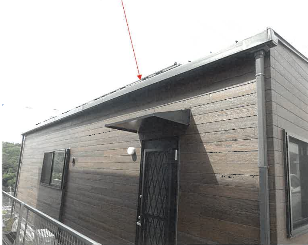
太陽光パネル
