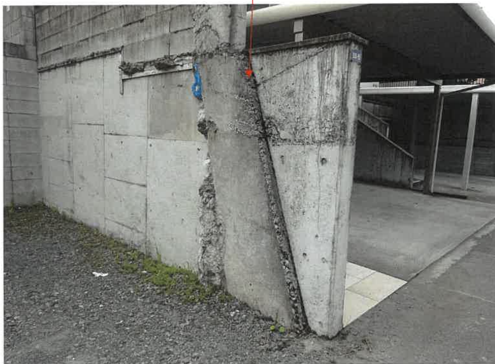
本件土地にはみ出し可能性がある部分
