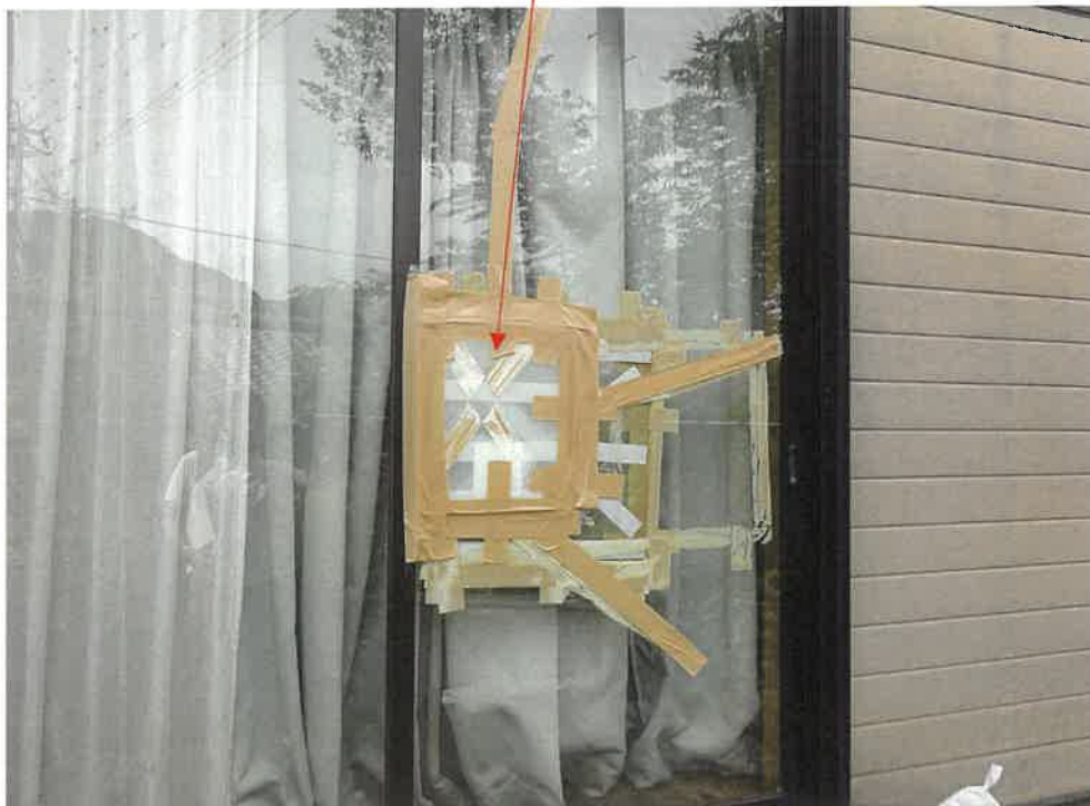
サッシの破損
