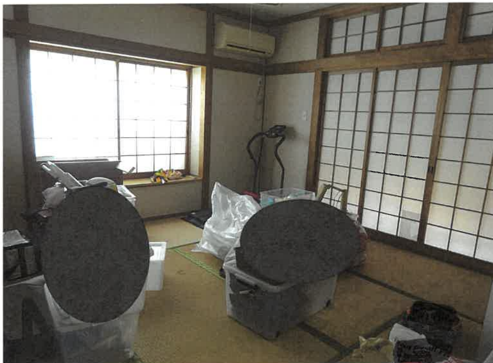
写真12 縁側に貼られたフィルムの剥がれの状況
