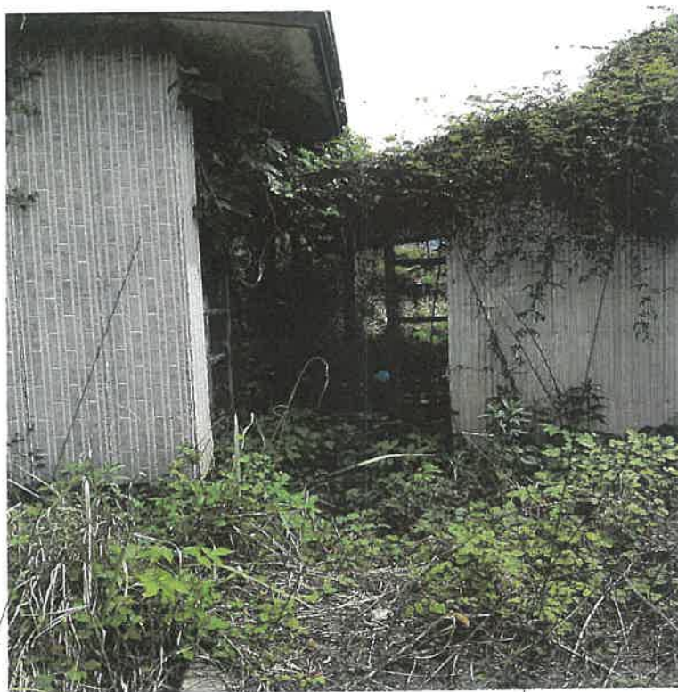
物件 2 屋根破損箇所 写真 10
