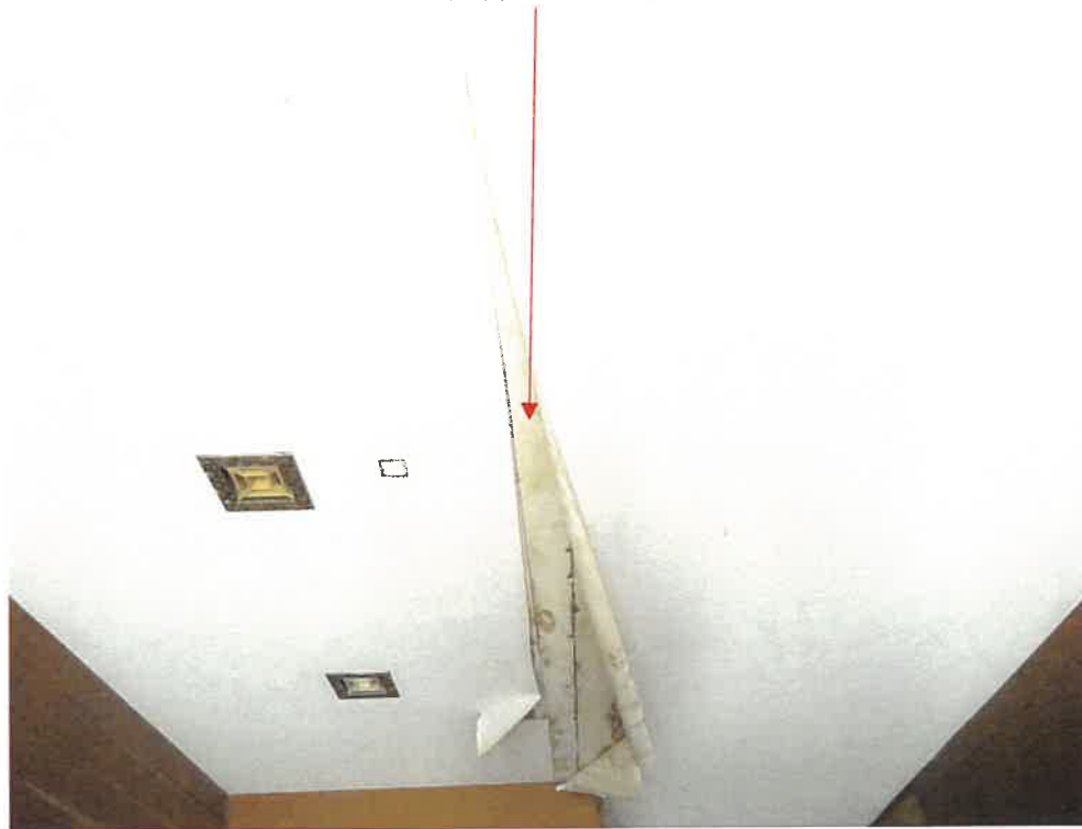
天井の雨漏り箇所
