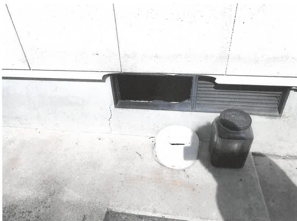
基礎部分の通気口の破損
