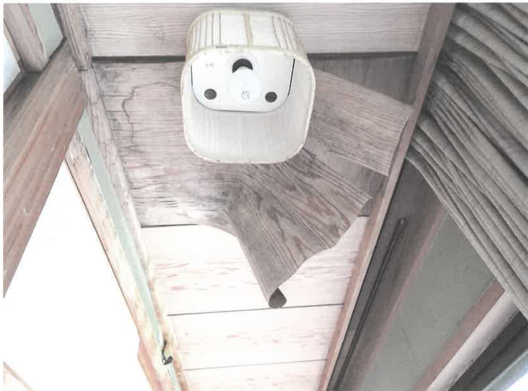
天井部分の剥がれ
