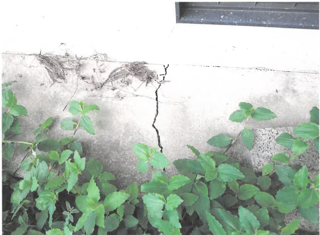
犬走りの亀裂
