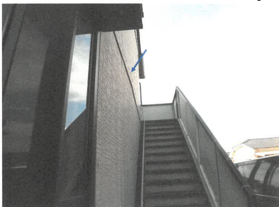
膨らみ部分の様子
