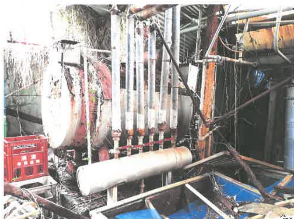
機械器具 ② （多管式貫流ボイラー）
