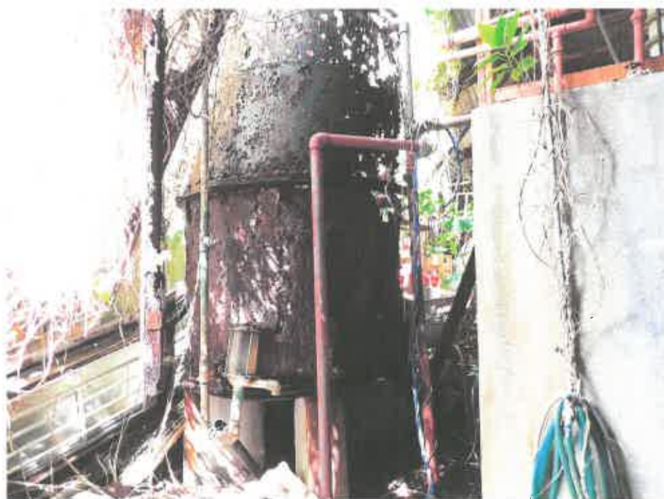
機械器具 ④ (腐食した特定不能な機械)
