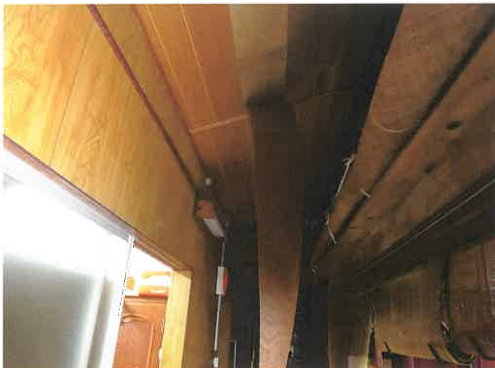
写真18 シロアリ被害の可能性がある床の傷み
