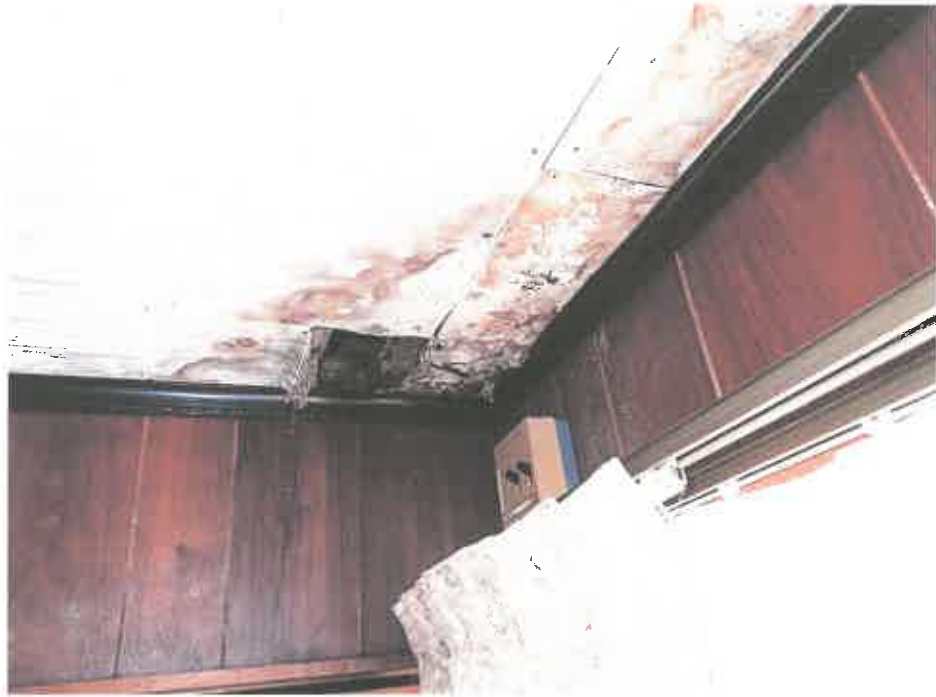
物件 4 (符号 1) 天井の状況
