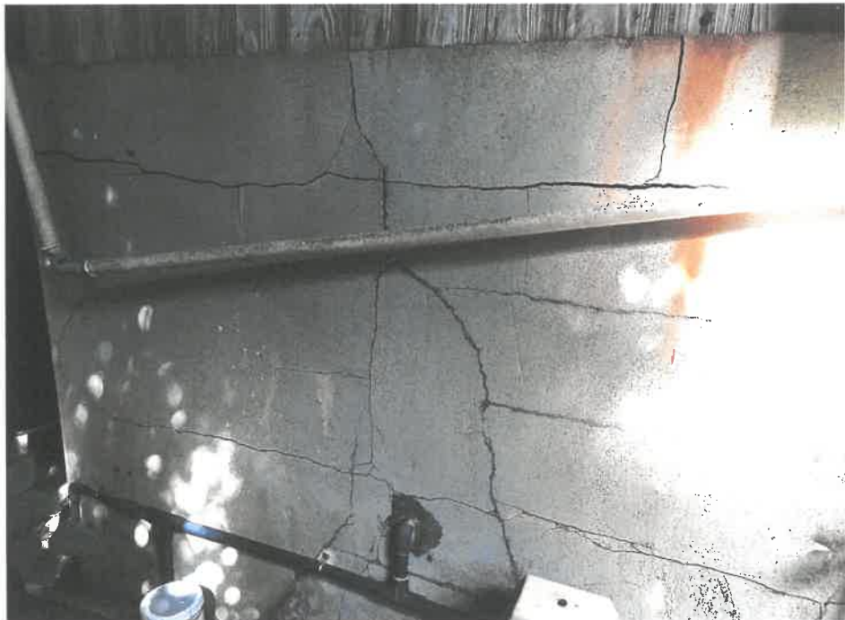
物件4(符号1) 外壁の損傷
