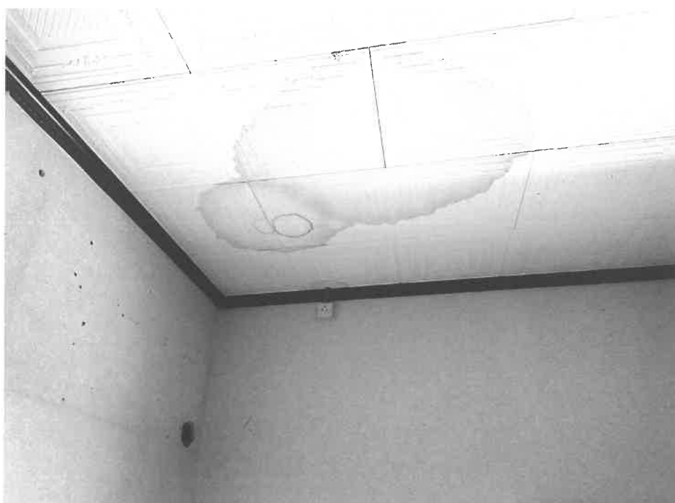
天井の雨漏り跡
