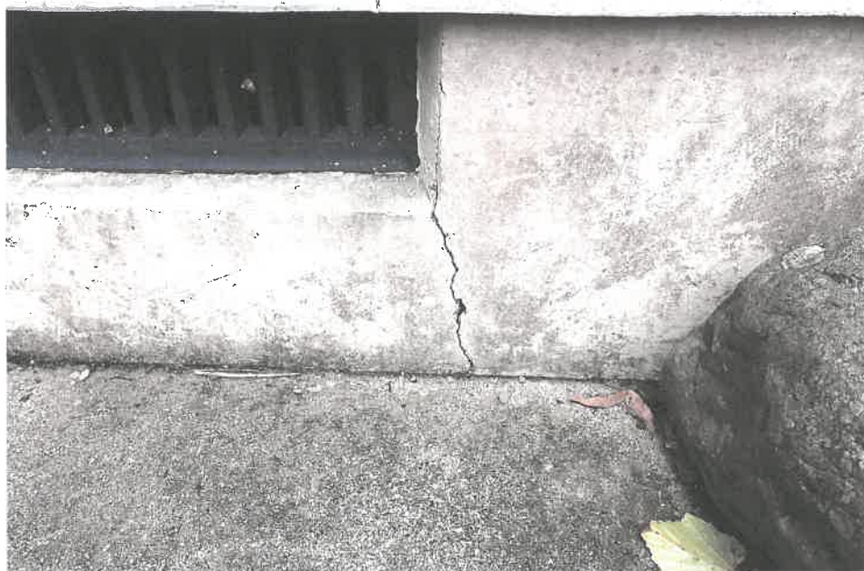
基礎のヒビの状況
