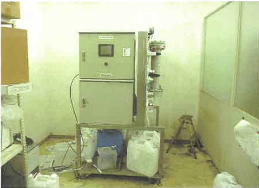
⑭機械・器具等目録⑧ (薬液精製装置)
