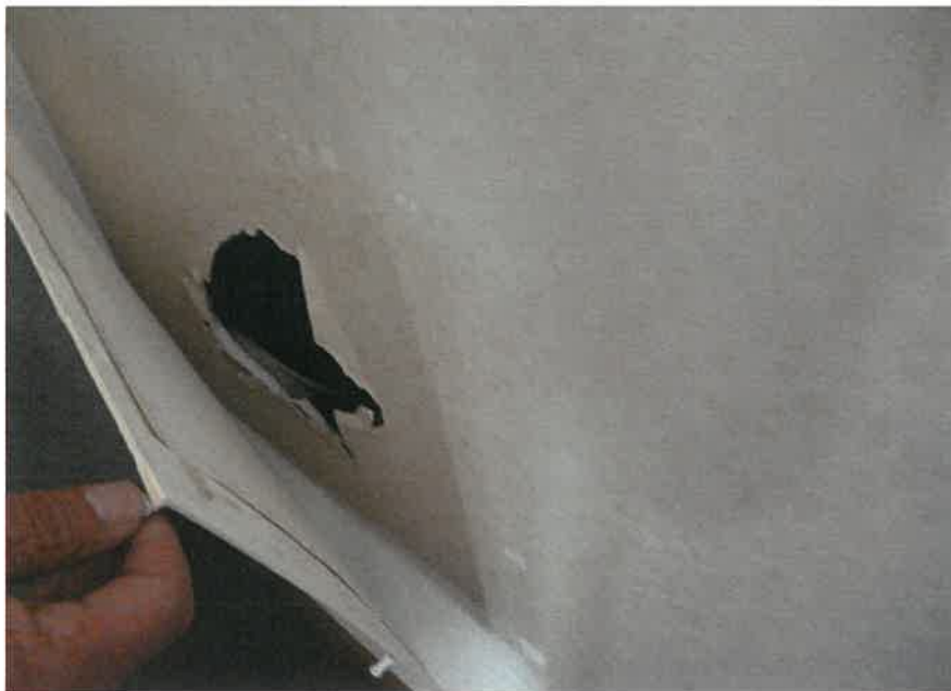
⑦洗面所とトイレの間 の壁の穴
