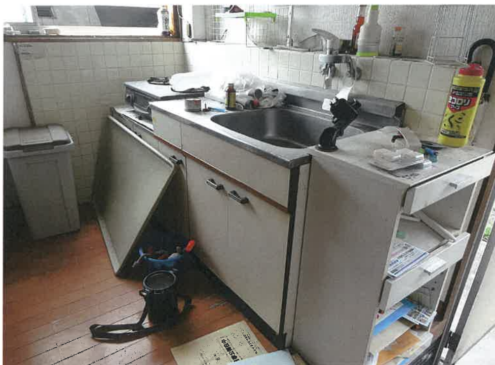
写真20 クロスの剥がれ
