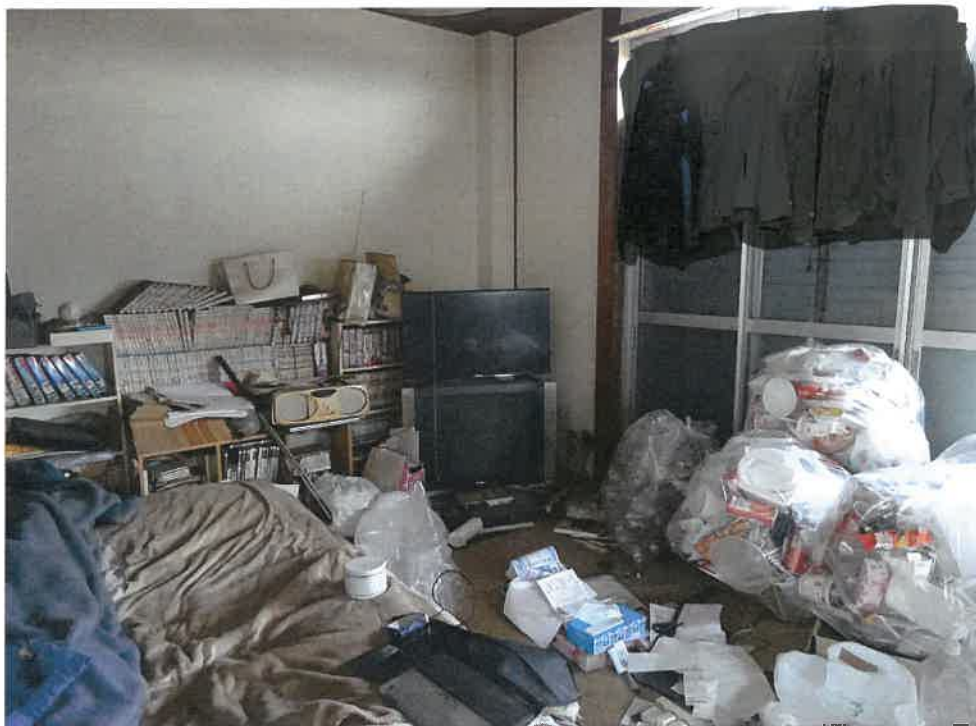
写真38 クロスの剥がれ
