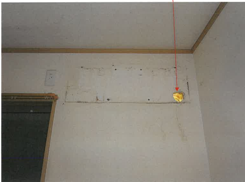
エアコン撤去後の穴
