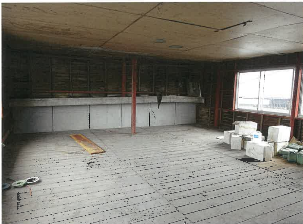
写真18 雨漏り跡と思われる天井、壁の染み
