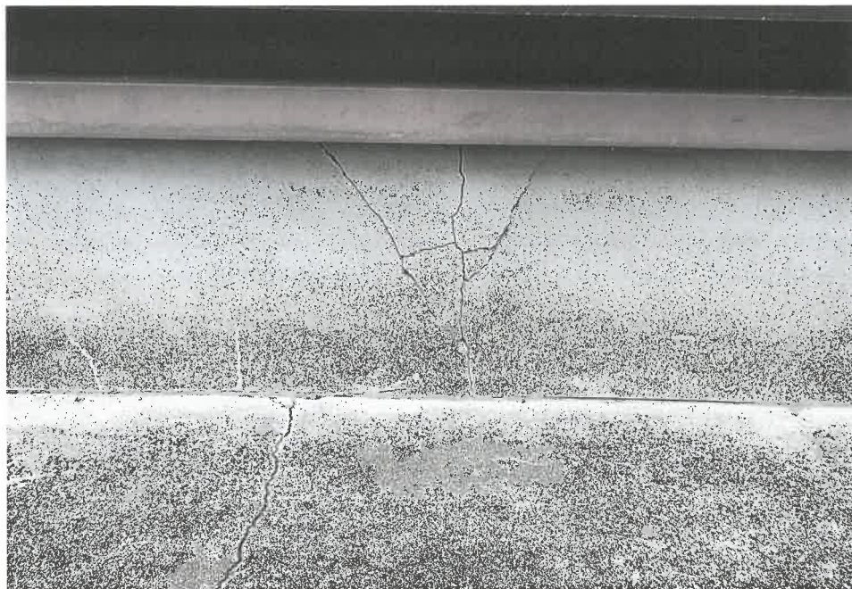
基礎・犬走のひび割れ
