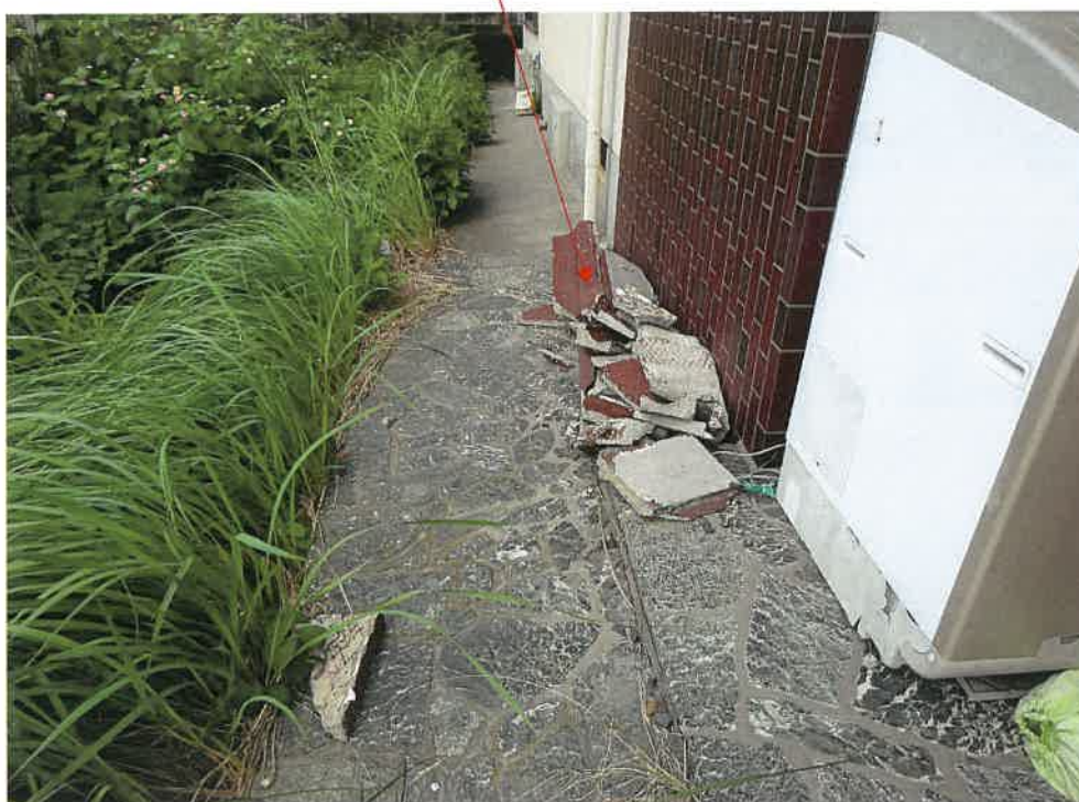
崩れ落ちた外壁材
