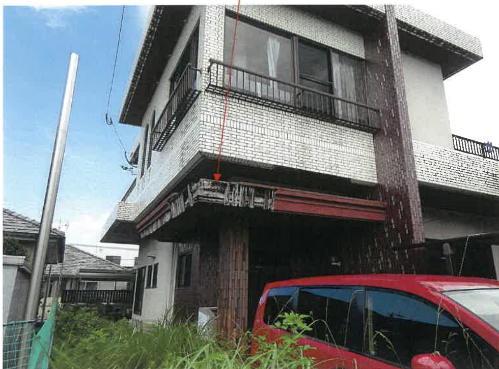
外壁材の損壊
