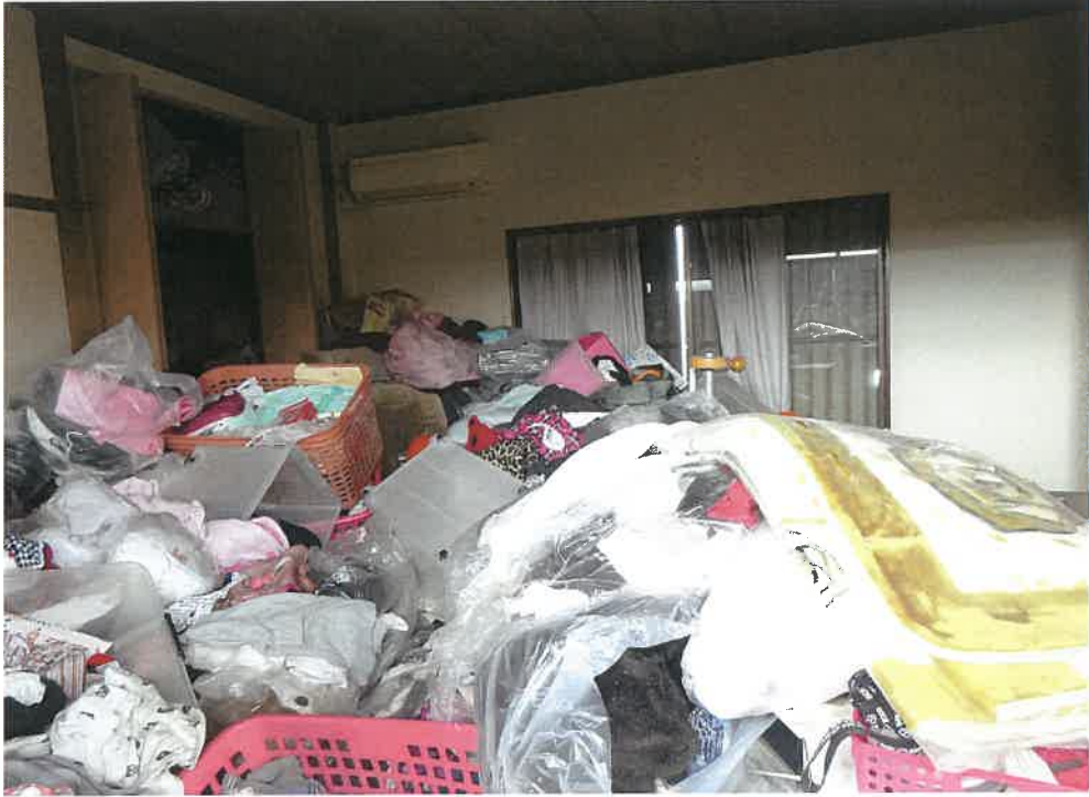
写真20 水はけが悪いベランダの状況
