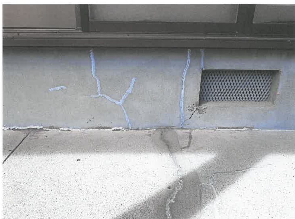
物件4 基礎・犬走りのヒビの補修跡
