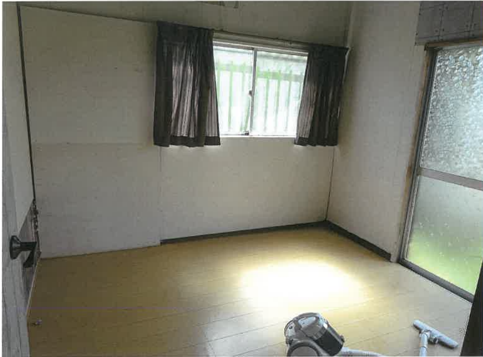
写真22 クロスの剥がれ等
