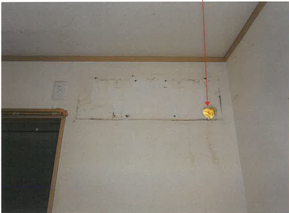
エアコン撤去後の穴
