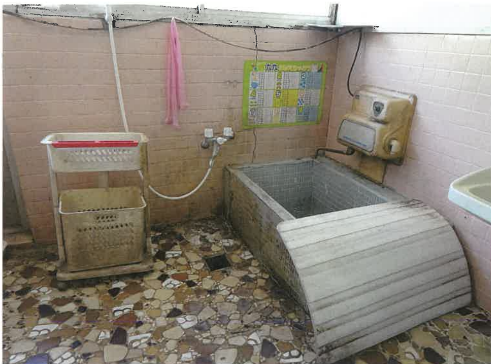
写真16 雨漏り跡と思われる天井の染み
