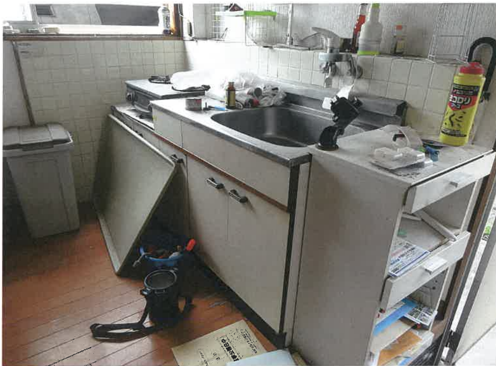
写真20 クロスの剥がれ
