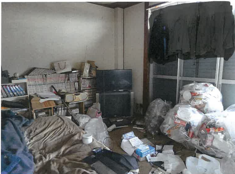
写真38 クロスの剥がれ
