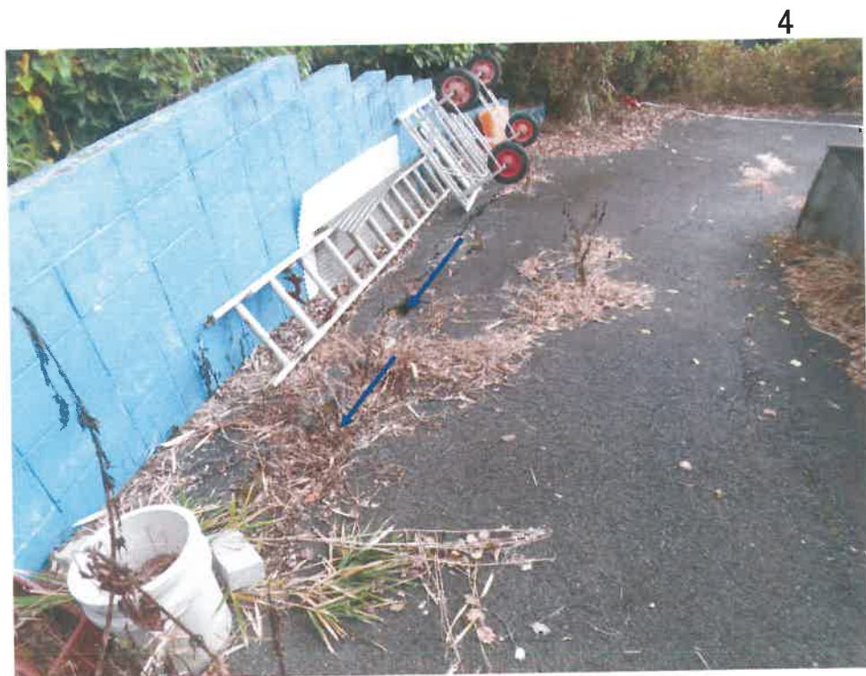
地盤の陥没の様子
