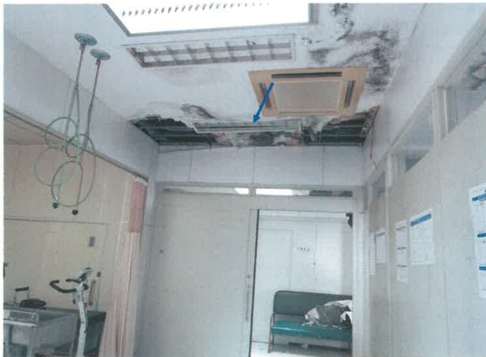
雨漏り跡の様子
