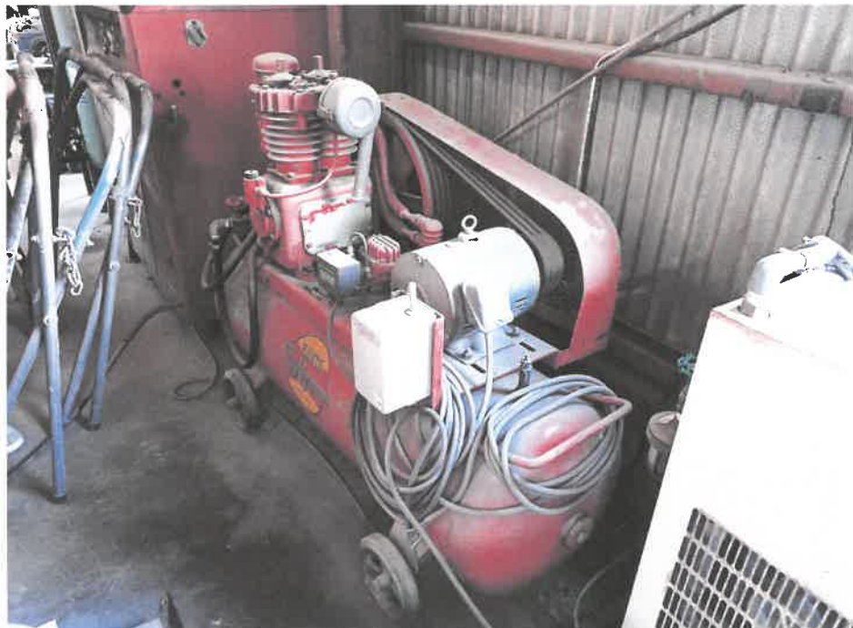
機械器具 ⑧ (コンプレッサー)
