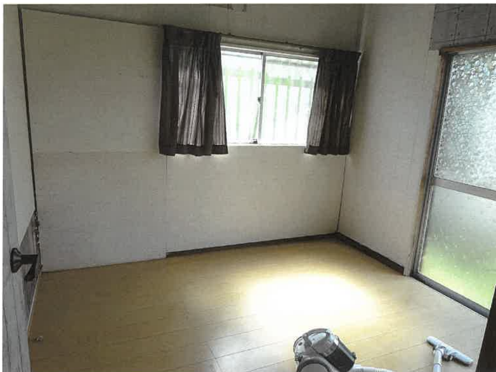
写真22 クロスの剥がれ等
