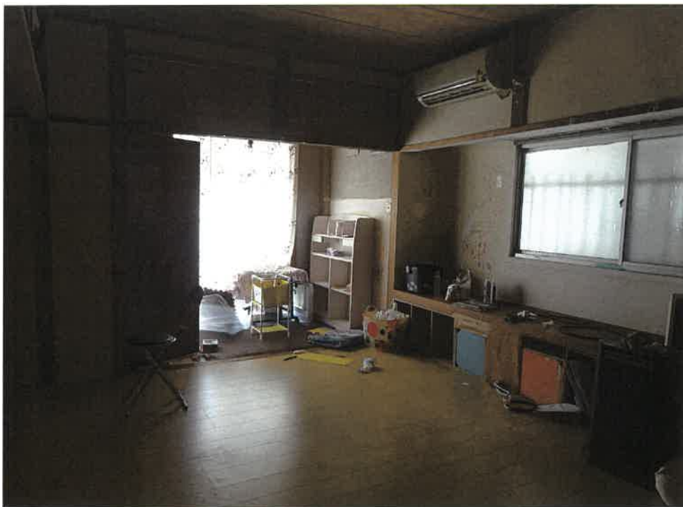
写真20 内壁の落書き等
