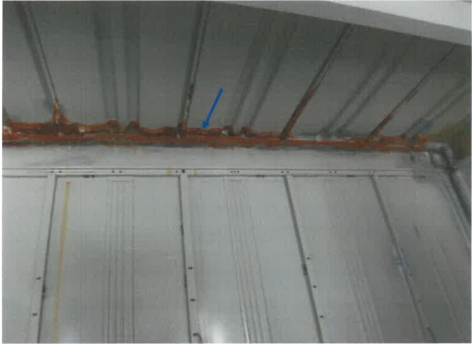
雨漏り跡の様子
