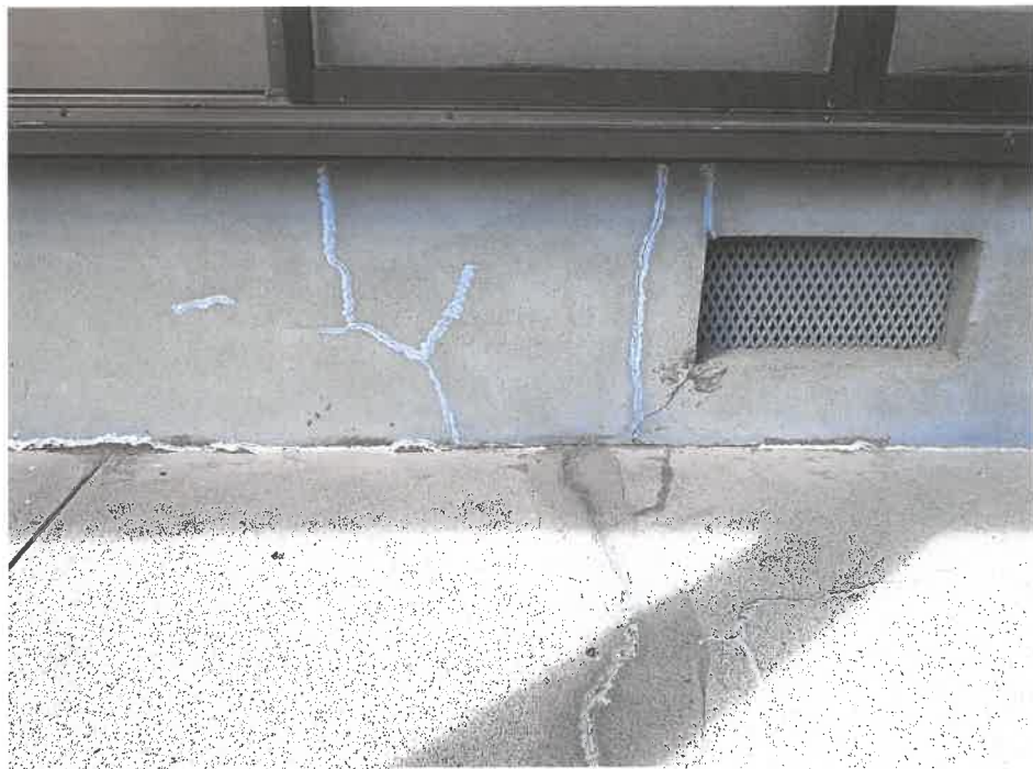
物件4 基礎・犬走りのヒビの補修跡
