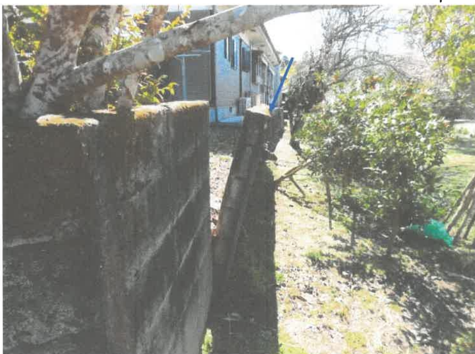
ブロック塀の傾きの様子
