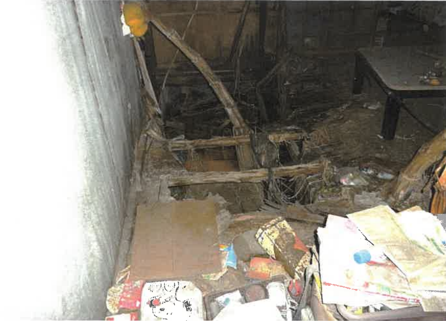
⑩床崩落箇所
