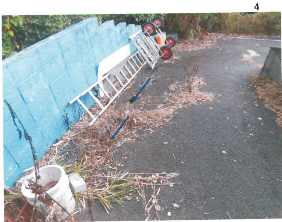
地盤の陥没の様子
