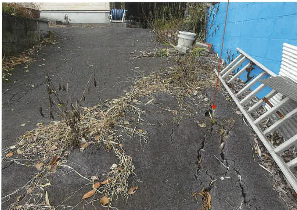
アスファルトの割れ
